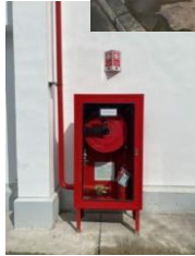
ตู้เก็บสายฉีดน้ำดับเพลิง
